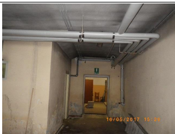
Tubazioni con coibente in FAV nelle cantine e nei vespai
