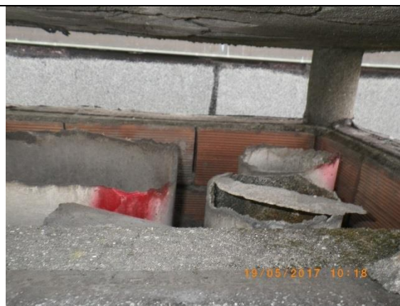
Canali di esalazione in un cavedio del corpo ala nuova
