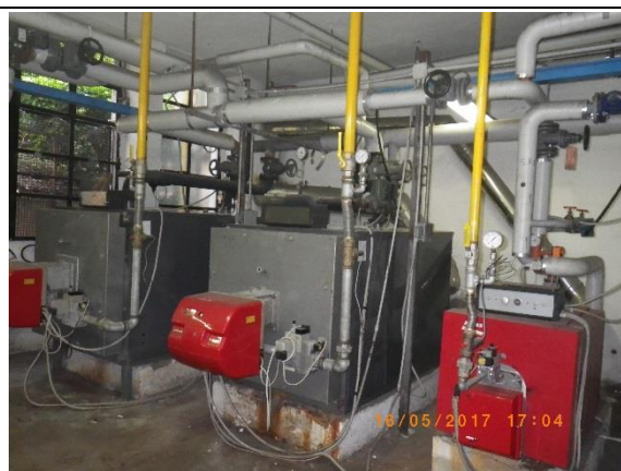
Tubazioni e caldaie con coibente in FAV nella centrale termica
