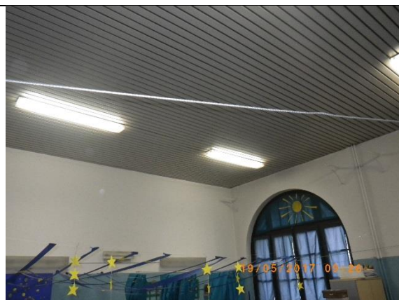
Controsoffitti con materassini isolanti in FAV nel corpo lato palestra
