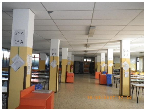
Pannelli dei controsoffitti in FAV nella mensa
