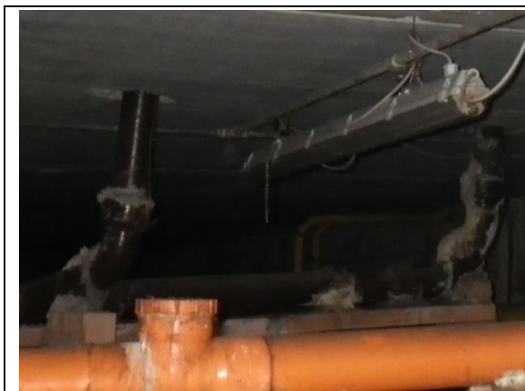
Tubazioni con coibente in FAV nel vespaio
