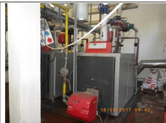
Caldaie e tubazioni con coibente in FAV nella centrale termica della scuola
