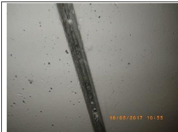
Residui di intonaco a base amianto sui plafoni dei piani da rialzato a secondo
