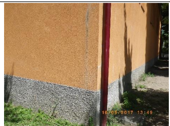
Pannelli in cemento-amianto dei muri perimetrali rivestiti esternamente da cappotto con intonaco e polistirolo
