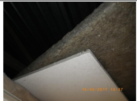
Materassini in FAV sopra i controsoffitti dell'ingresso e degli spogliatoi della palestra
