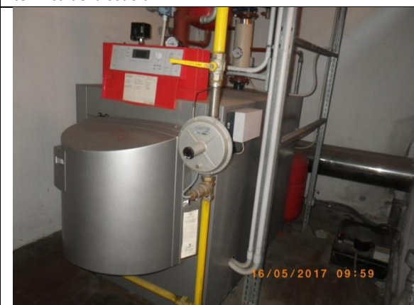
Caldaie e tubazioni con coibente in FAV nella centrale termica della palestra
